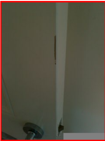
Bedroom 2 Door Door finish - chipped (above handle)
